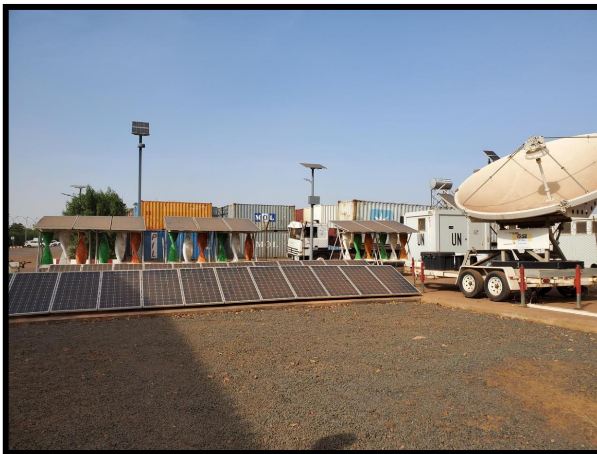
FIGURE 7 : ANTENNE SATELLITE ET PANNEAUX SOLAIRES INSTALLÉS SUR LE SITE D'UNE MISSION DES NATIONS UNIES
